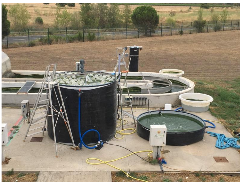
Figura 3.17: Quadro generale: vasca pilota ( 10,1 \text{ m}^3 ), vasca secondaria ( 2,4 \text{ m}^3 )
