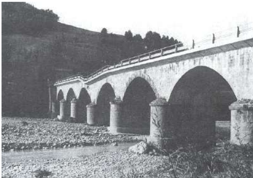
Figura 1 - Esempio di ponte danneggiato a causa del fenomeno dello scavo localizzato
