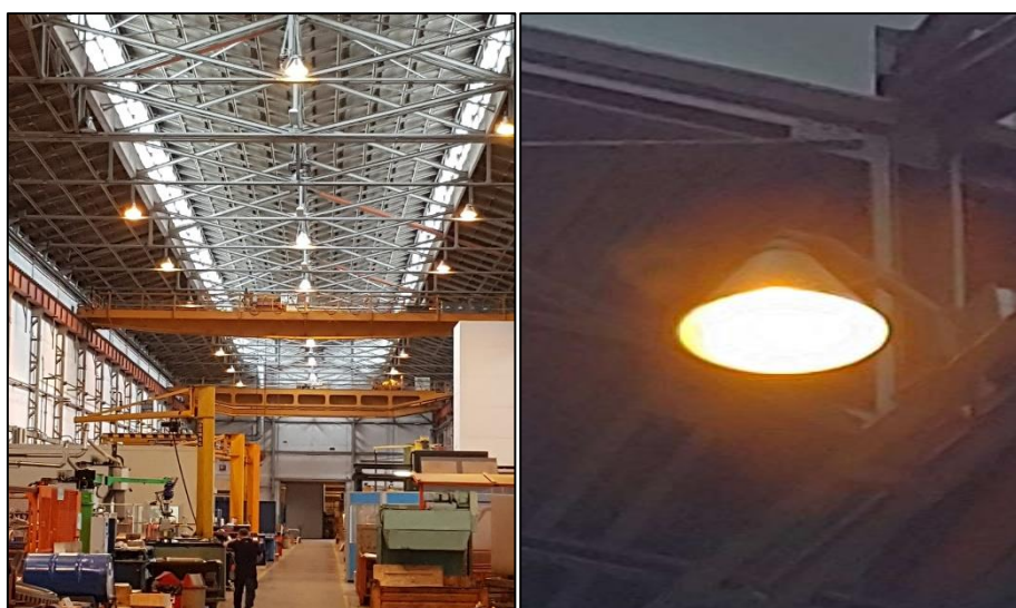
Figura 46: Campata con lampade a vapori di sodio
