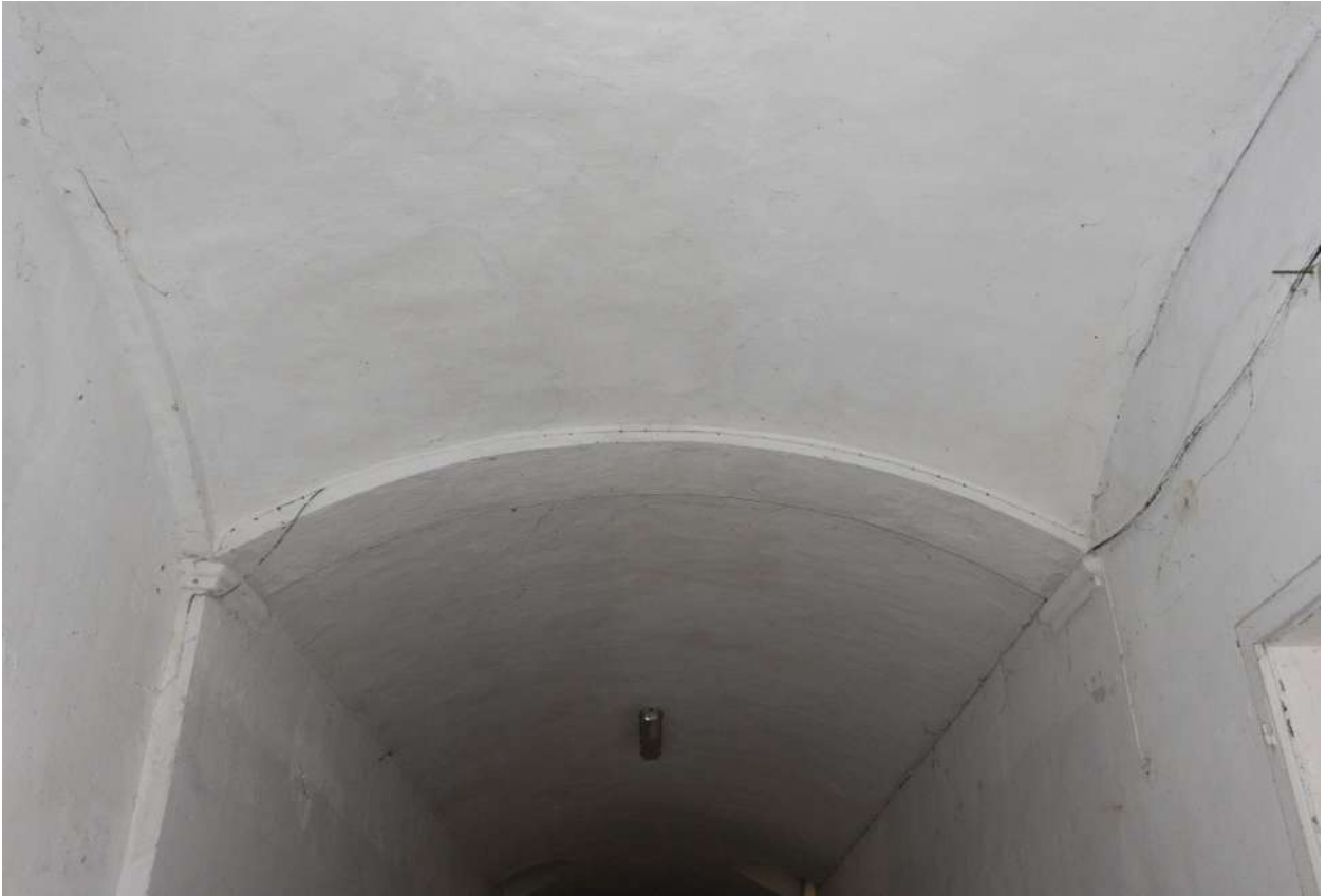
Figura 20. Ambiente con volta a vela all'incrocio tra i due corridoi. In fondo è visibile la volta a botte lunettata del corridore.
