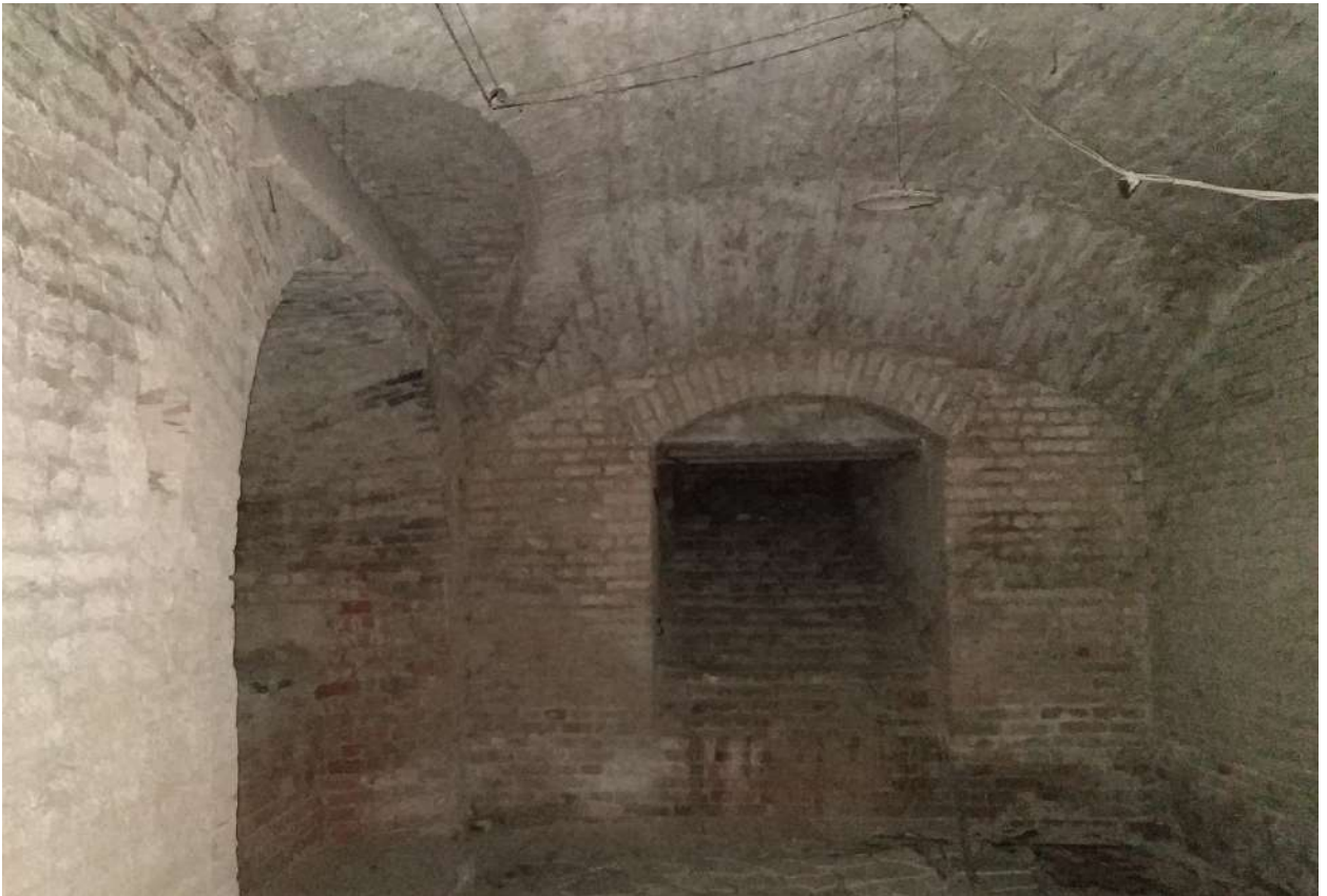
Figura 17. Cambiamento di copertura sopra la bocca di lupo.
