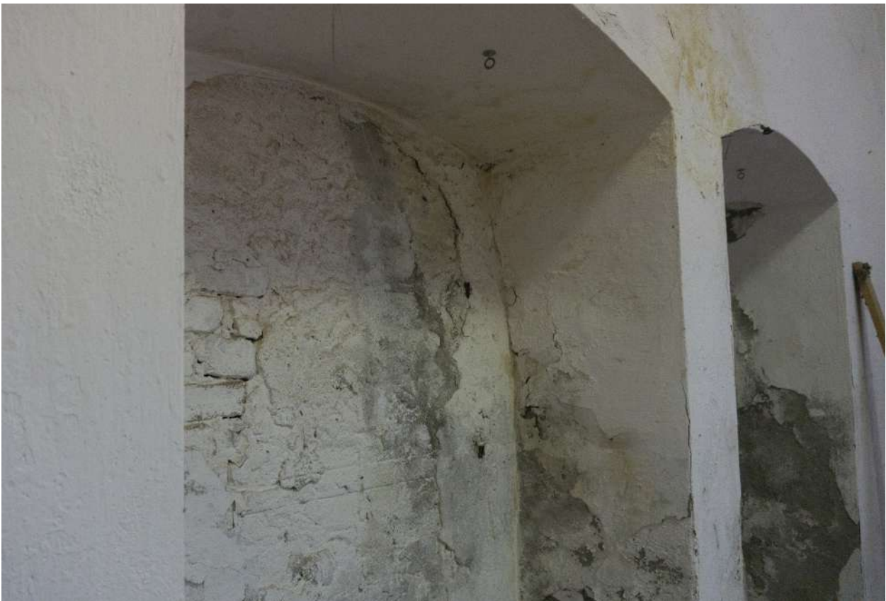
Figura 49. Muro non a piombo all'interno delle nicchie.
