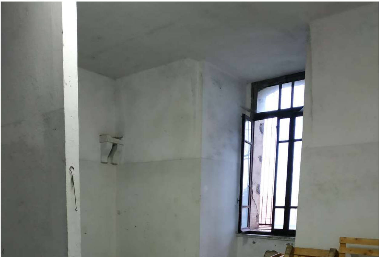
Figura 23. Camerata degli ufficiali posizionata a nord-ovest, con controsoffitto e traccia dell'imposta della lunetta sulla finestra e mensola nell'angolo.
