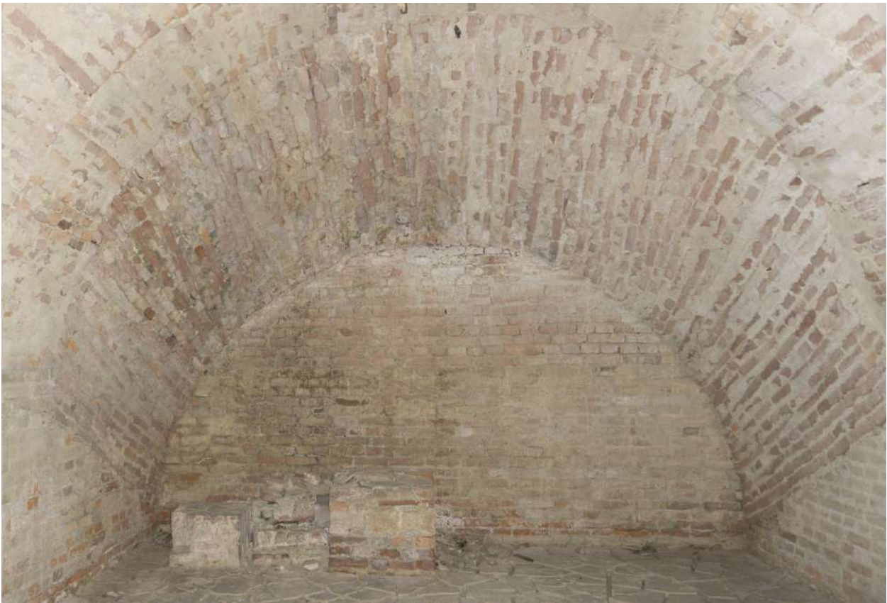
Figura 18. Cambiamento di inclinazione della copertura nelle stanze al di sotto delle latrine del piano terra.
