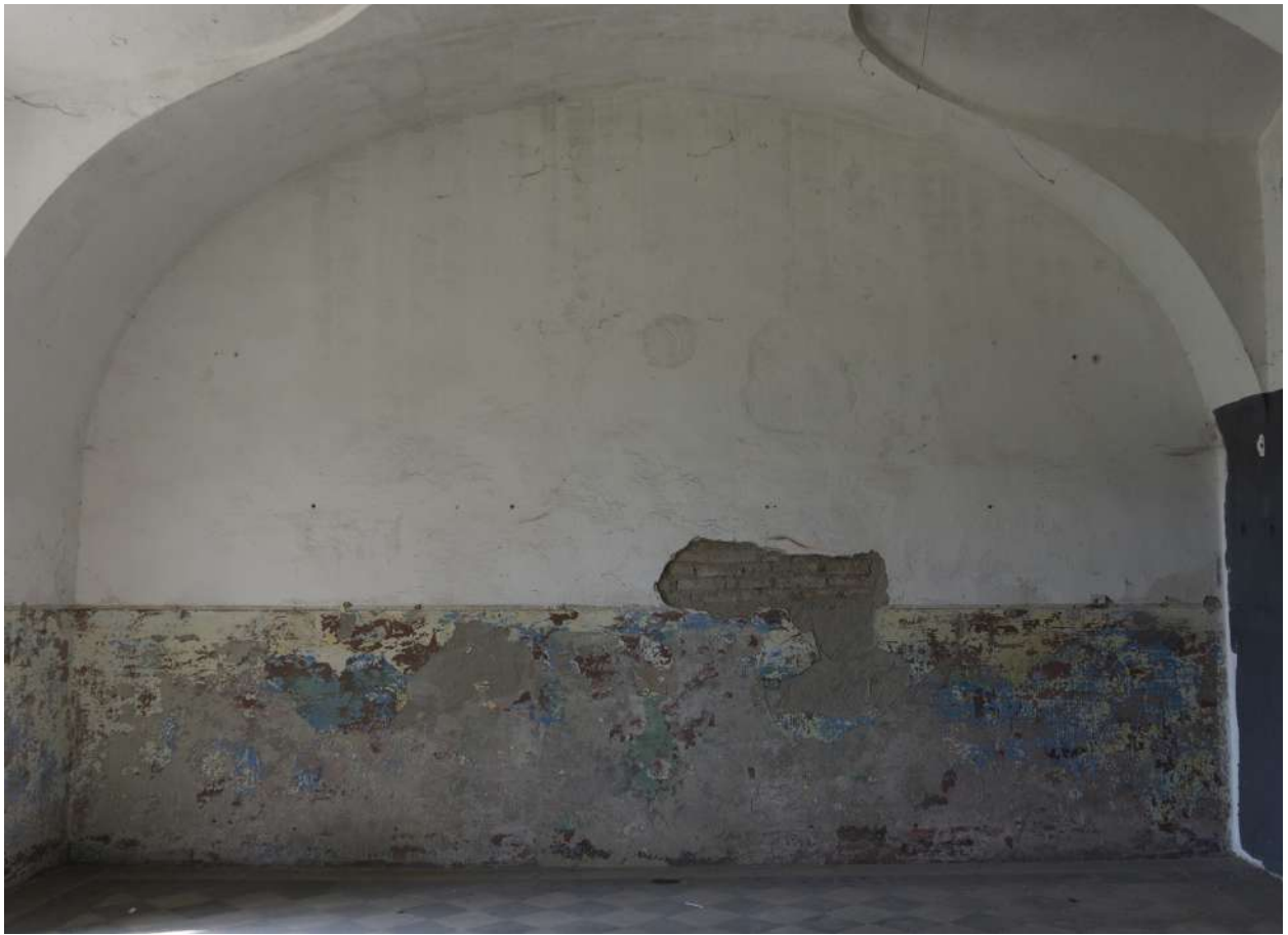
Figura 46. Al centro del muro, a circa 3m di altezza, si nota la bocchetta tamponata. Stanza all'estremo a nord nel piano terra.
