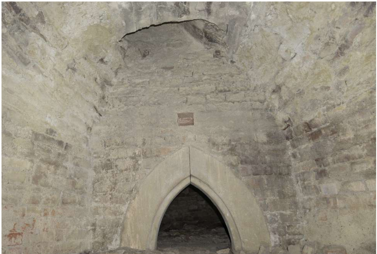
Figura 43. La canna fumaria posizionata all'esterno della bocca del forno e che devia verso l'interno della fabbrica.
