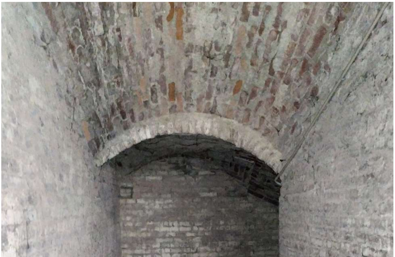
Figura 33. Volta a botte con generatrice inclinata sopra le rampe per scendere nei sotterranei.
