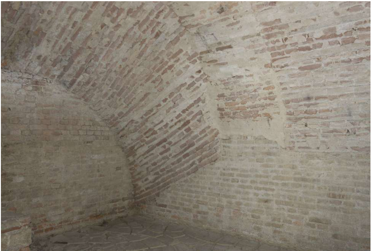
Figura 55. Strana inclinazione della copertura nei sotterranei, in corrispondenza delle latrine del pianterreno.
