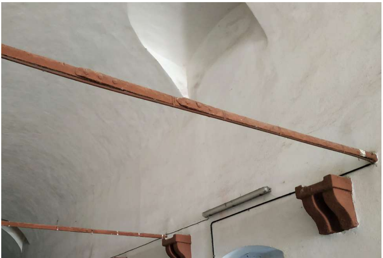
Figura 62. Una catena è composta da più pezzi di ferro che vengono inchiodati in corrispondenza della loro sovrapposizione.
