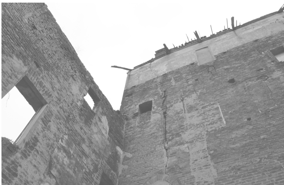
^ 5. Cortile interno Da notare la fessura passante in corrispondenza della canna fumaria. (fonte: foto dell'autore, sopralluogo 19/01/2019)
