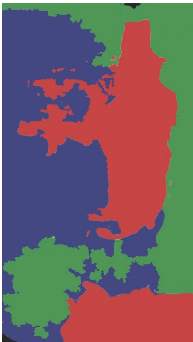
^ 17. Stralcio del prospetto Ovest con tre tipologie di degrado differenti Verde: Alterazione Cromatica; Blu: Disgregazione; Rosso:Distacco.
