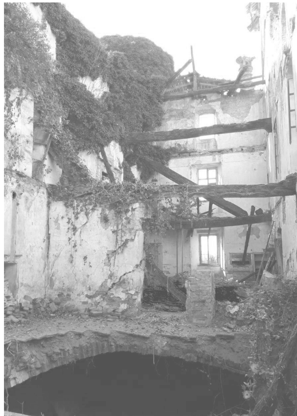
^ 6. Stanza ad est, piano rialzato. Parte del solaio è crollato rendendo scoperto l'interrato. (fonte: foto dell'autore, sopralluogo 17/04/2019)
