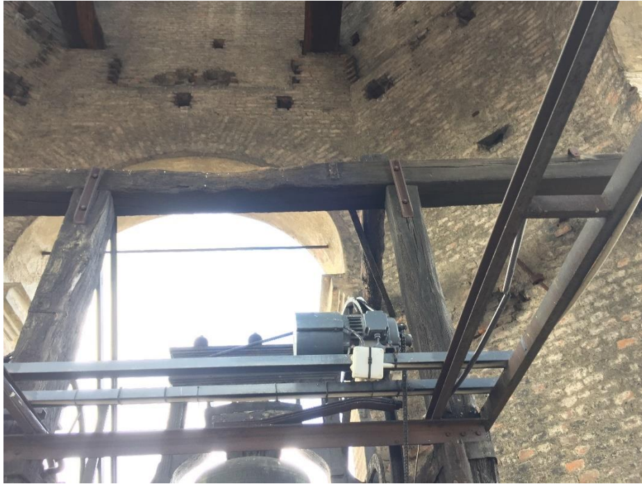
Figura 56. Elementi della "Struttura a" non ispezionabili
