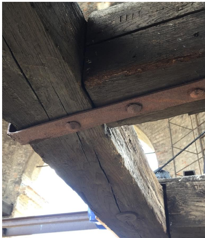
Figura 74. Deterioramento presente nel Traverso T1
