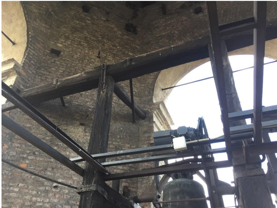
Figura 55. Elementi della "Struttura a" non ispezionabili
