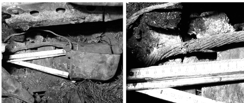
Figura 49 Immagine rappresentativa dell'entità dei danni dovuti al cortocircuito della batteria nell'autocarro numero 1
