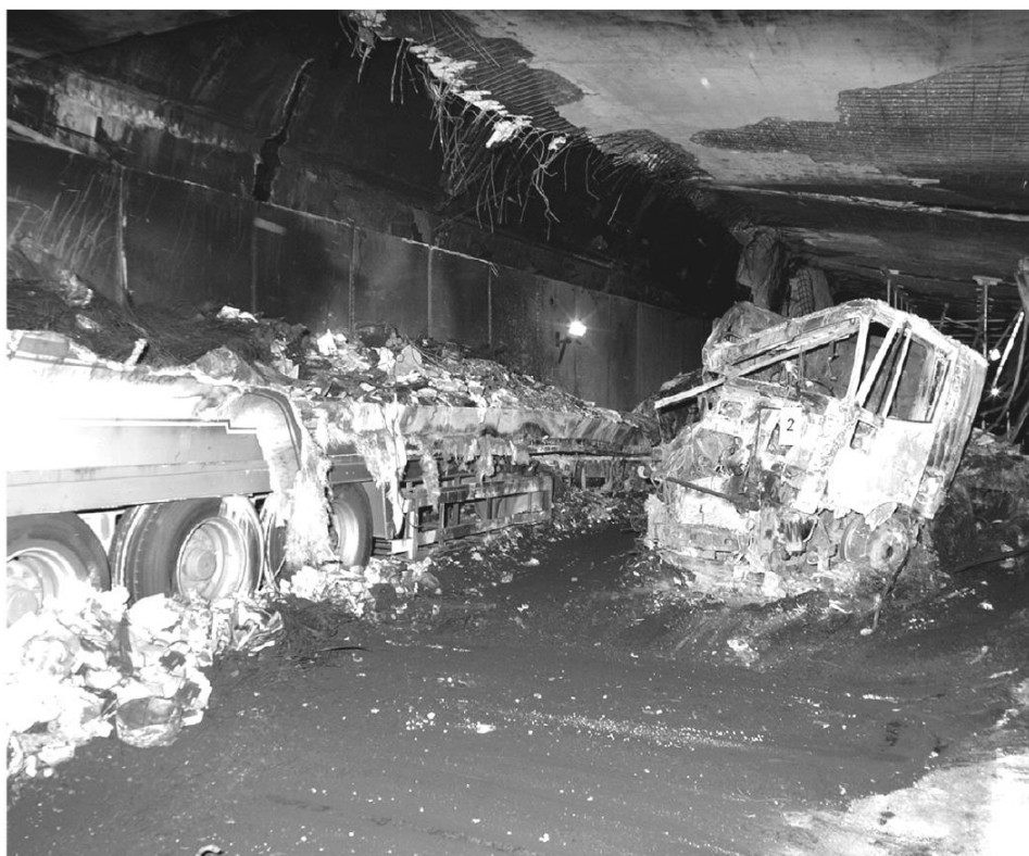
Figura 44 Danni strutturali sopra l'autocarro 1 e l'autocarro 2
