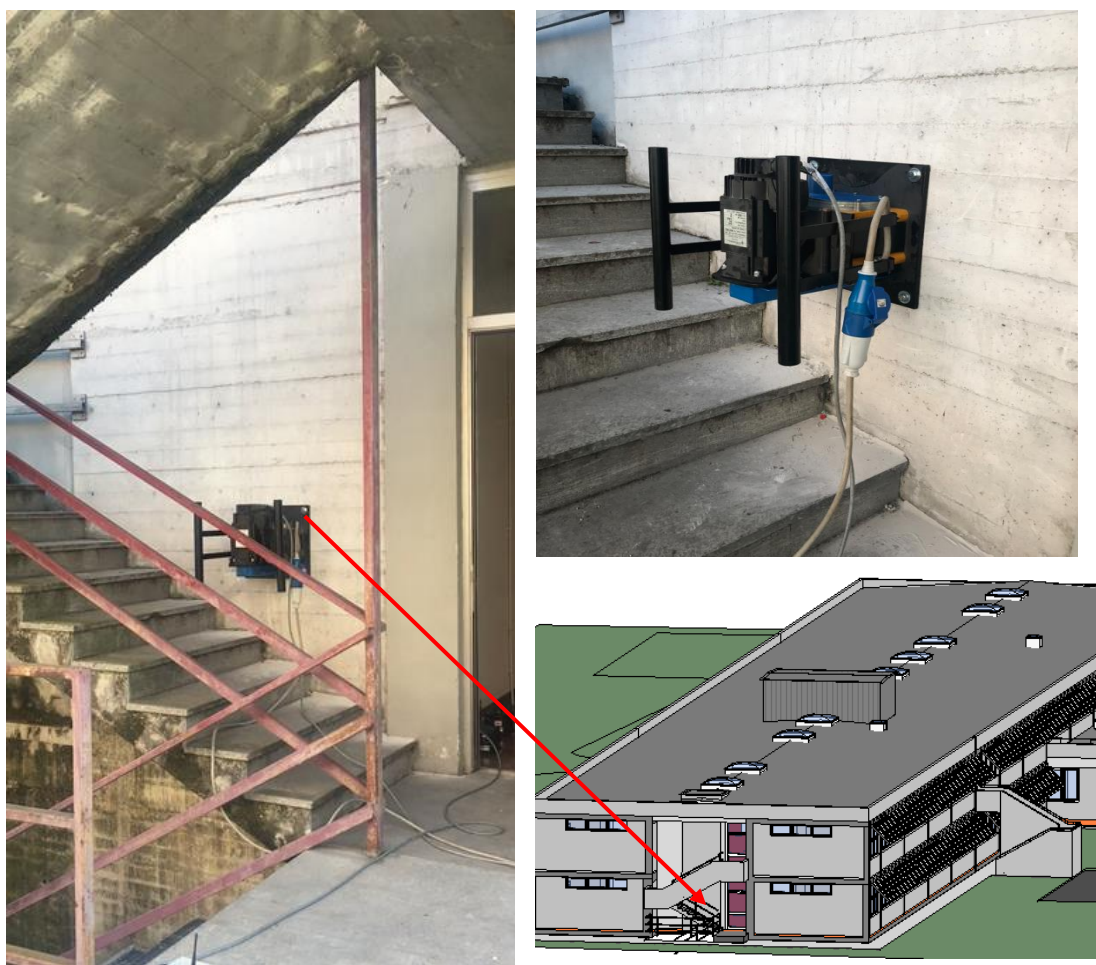
Figura 47. Vibrodina installata su parete di taglio dell'edificio classi
