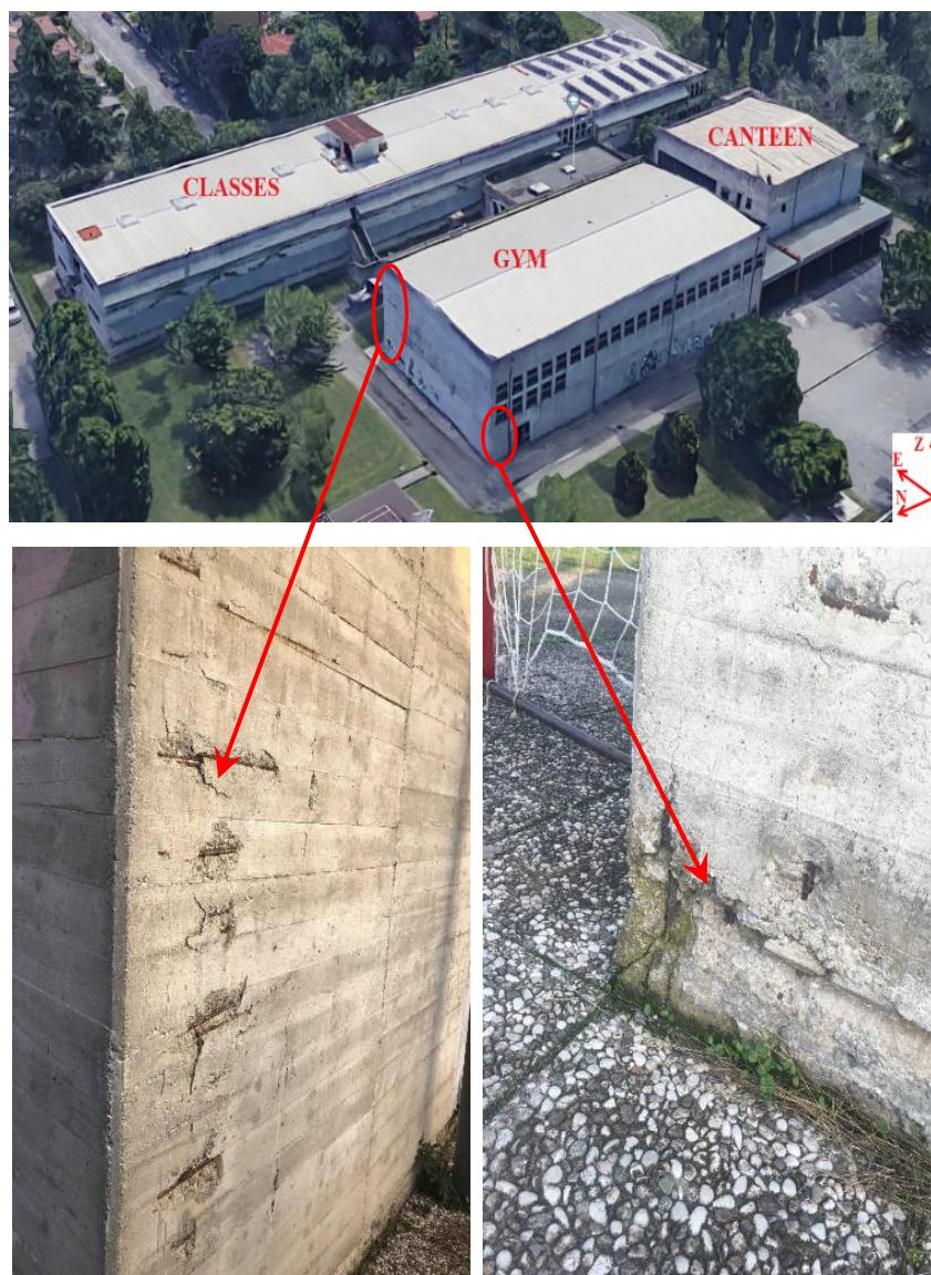
Figura 32. Corrosione delle barre di armatura e fessurazione del calcestruzzo
