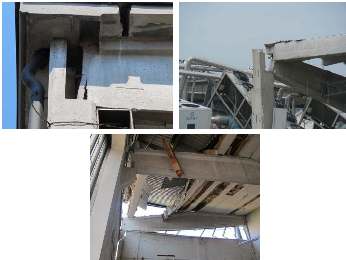
Figura 81. Perdita di appoggio della trave principale e scivolamento degli elementi di copertura, Emilia Romagna 2012 (ReLUIS and CNI, 2012)
