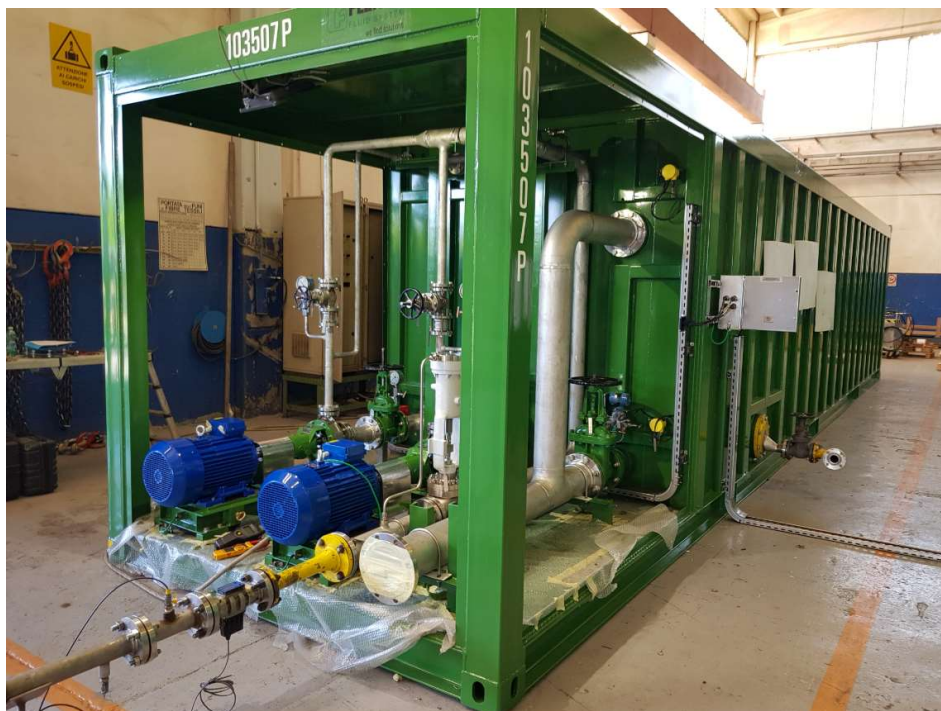
Figura 49: foto dell'impianto in fase di collaudo
