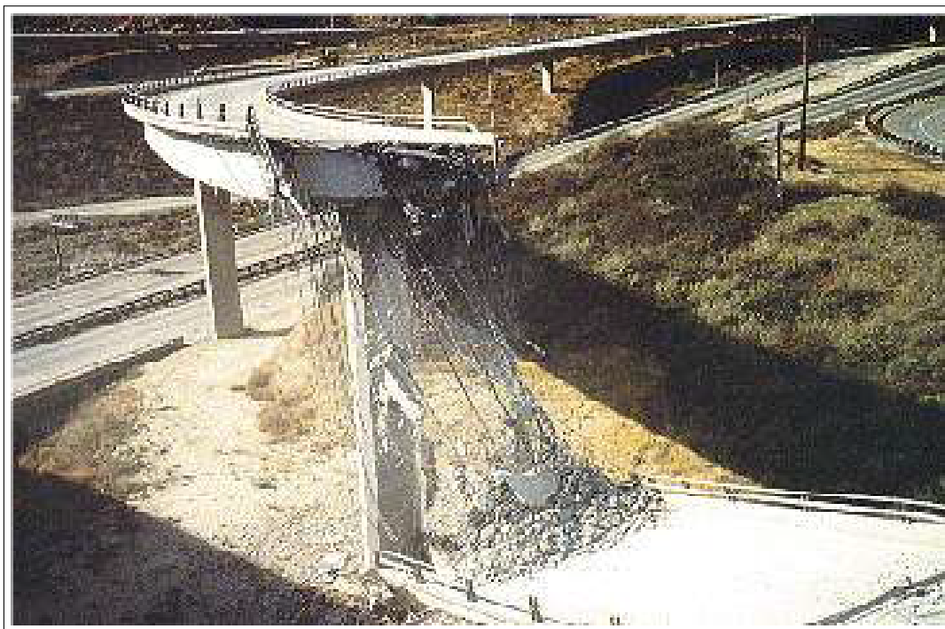
Figura 2.4: Collasso dell'impalcato dovuto alla rottura della pila durante il terremoto di Northridge, 1994.
