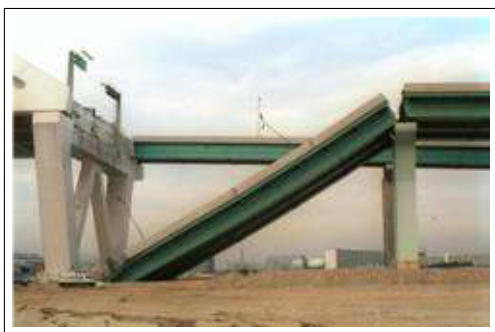
(a) Esempio di collasso per sfilamento dovuto al terremoto di Kobe (1995)
