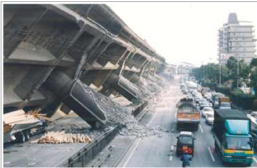
Figura 2.6: Ribaltamento del viadotto dovuto al collasso della pila, terremoto di Kobe, 1995.
