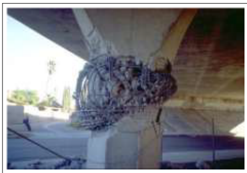
(a) Esempio di collasso per taglio di pile da ponte, terremoto di Northridge, 1994.
