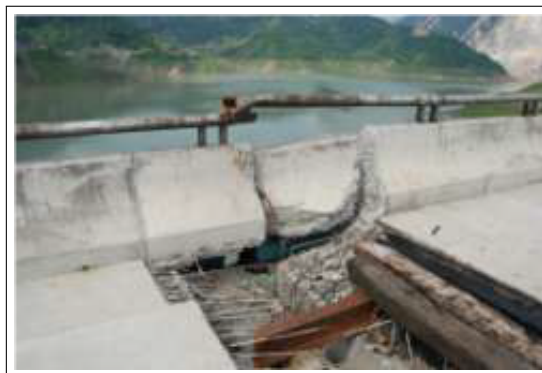
(b) Esempio di danneggiamento per pounding dovuto al terremoto di Sichuan, 2008.
