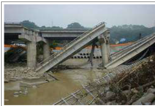
(b) esempio di collasso per sfilamento dovuto al terremoto di Chi-Chi (1999).
