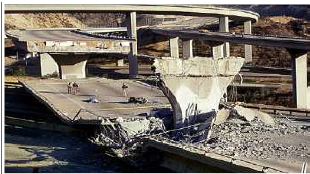
Figura 2.1: Gravi danni sismici riportati da un viadotto in seguito al terremoto di Northridge, 1994.
