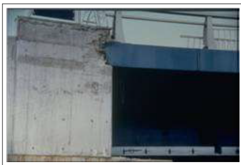
(a) Esempio di danneggiamento per pounding dovuto al terremoto di Kobe (1995).
