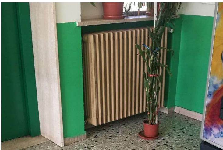
Figura 9.2: radiatore in ghisa su parete esterna, in sottofinestra.
