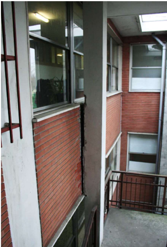
Figura 7.12: dettaglio del distacco del pilastro dalla facciata.
