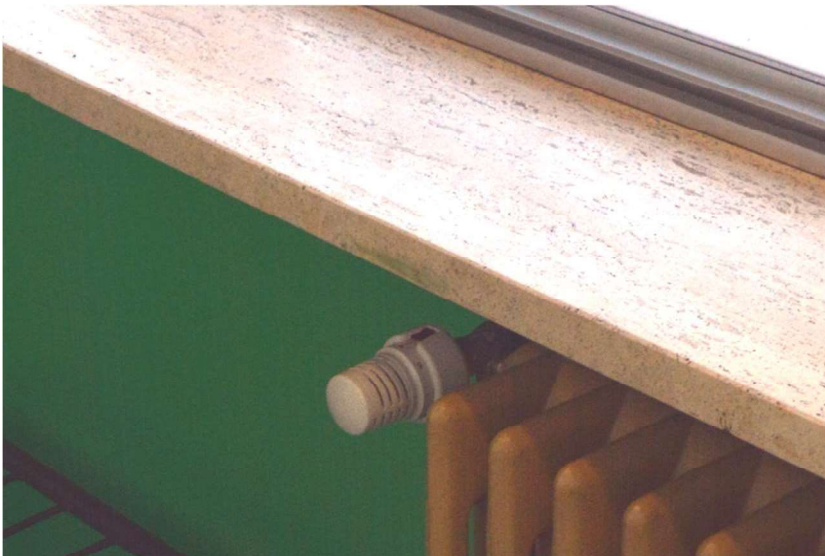
Figura 9.4: valvola di termoregolazione su radiatore in ghisa.
