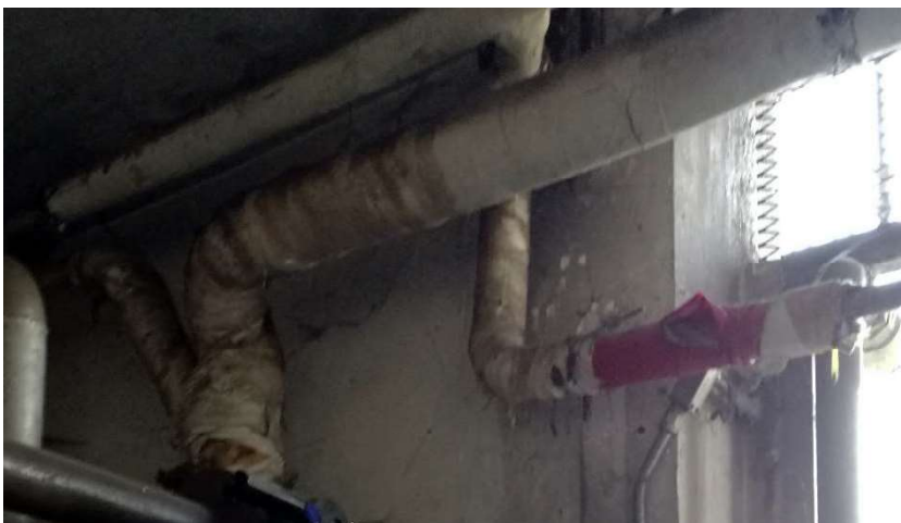
Figura 9.5: isolamento delle tubazioni nel vano tecnico caldaia, porzione aule.
