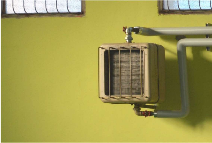
Figura 9.3: ventilconvettore a parete, palestra.
