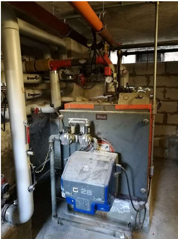
Figura 9.8: caldaia a metano originaria.
