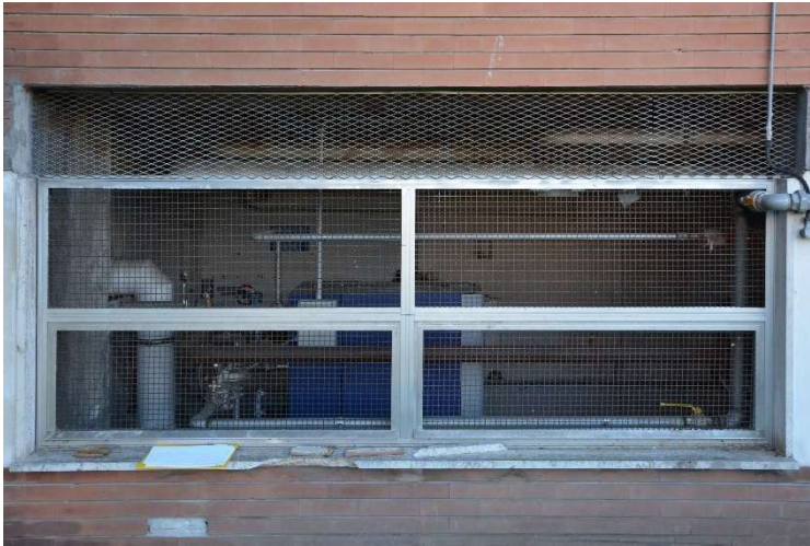
Figura 9.1: apertura per areazione su muratura esterna del vano tecnico della caldaia.
