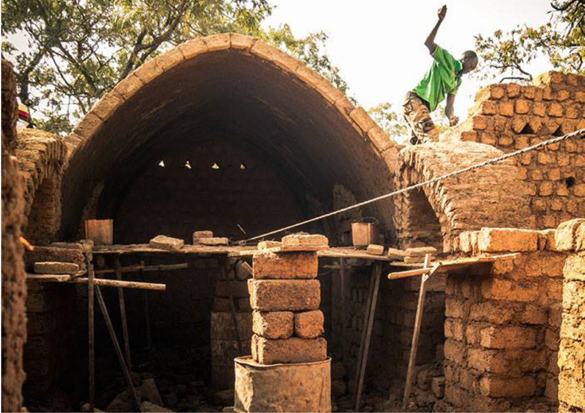
Immagine 20: L'inizio della costruzione della volta nubiana nel refettorio del modulo 1. Foto di Roof4life
