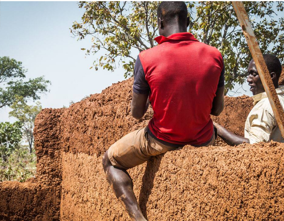
Immagine 8: Muratura in cob, cantiere Cape Birim. Posatura di un nuovo strato sullo strato essiccato sottostante. Foto di Roof4life 2016
