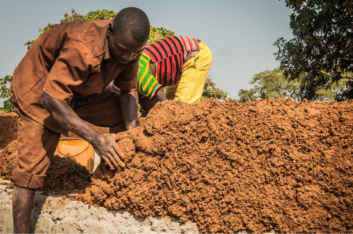
Immagine 7: Muratura in cob, cantiere Cape Birim. Gettata dello strato inferiore della muratura. Foto di Roof4life 2016
