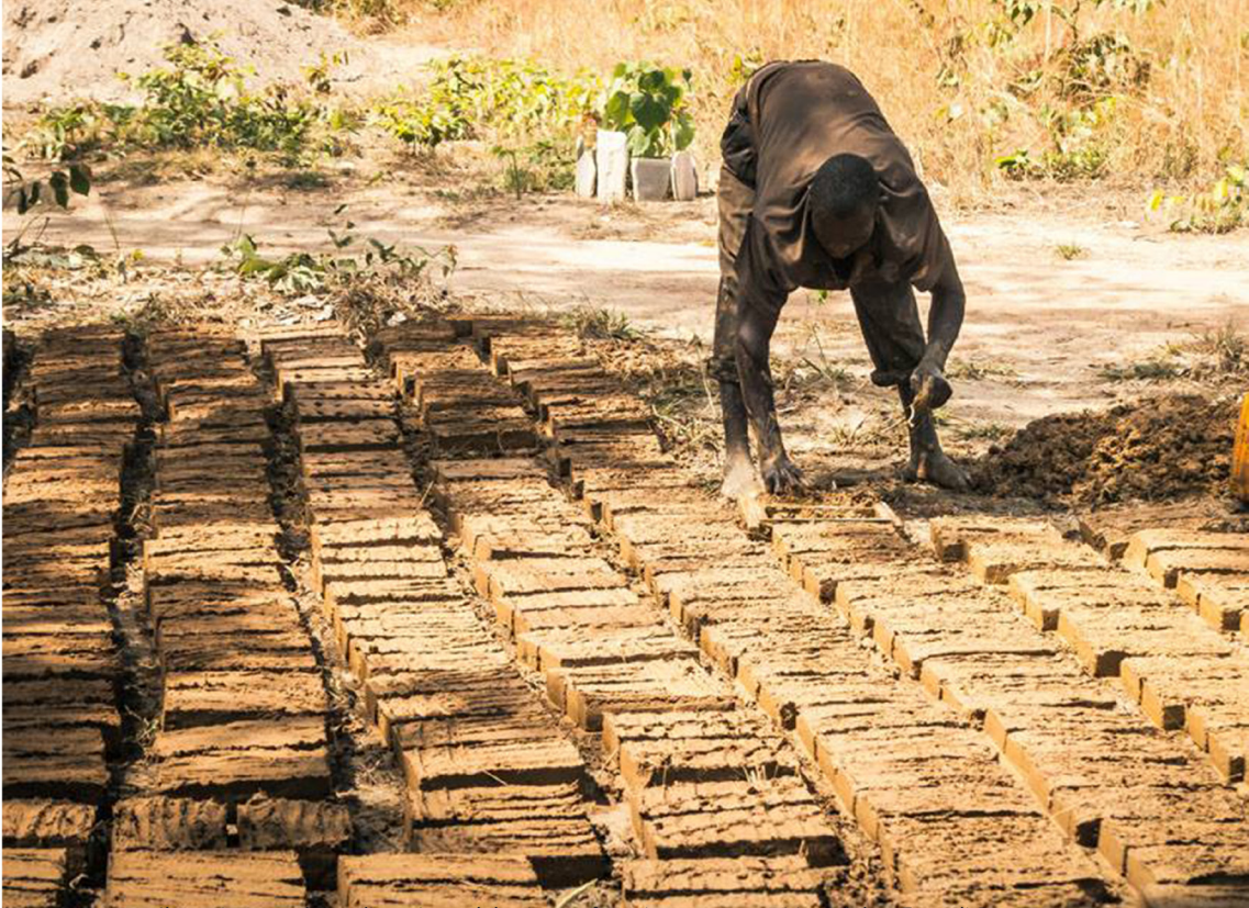
Immagine 15: Il cantiere per la realizzazione del primo refettorio con mattoni in Adobe. Foto di Roof4life.
