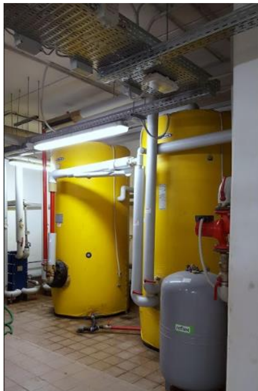
Figura 8: Serbatoi di accumulo presenti in centrale termica
