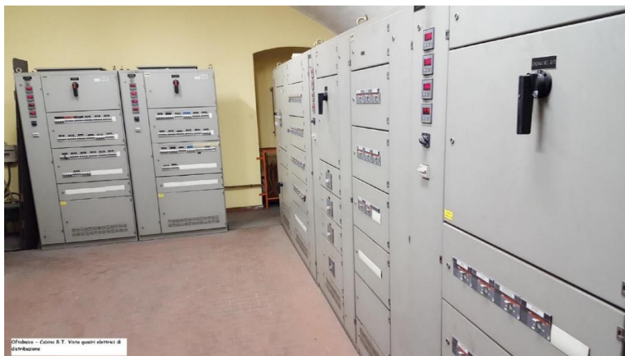
Figura 10: esempio di cabina di bassa tensione
