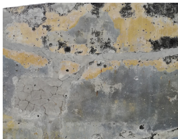
Fig. 91: Presenza di macchie nere sul materiale nella parte esterna del baluarte. Degrado dovuto all'esposizione e all'azione costante dell'acqua.
