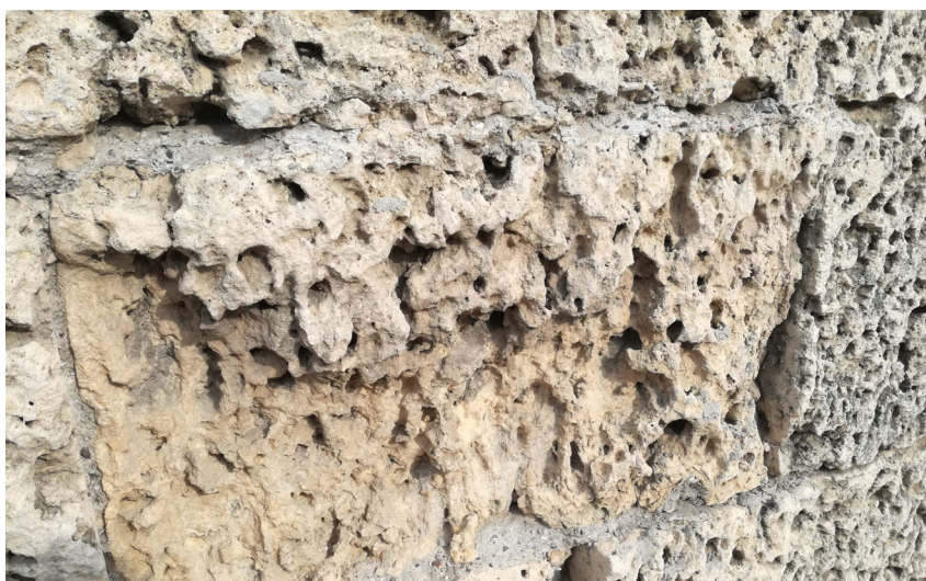
Fig. 95: Alveolizzazione del materiale lapideo del baluarte. Processo dovuto dall'azione di aria e acqua costanti.
