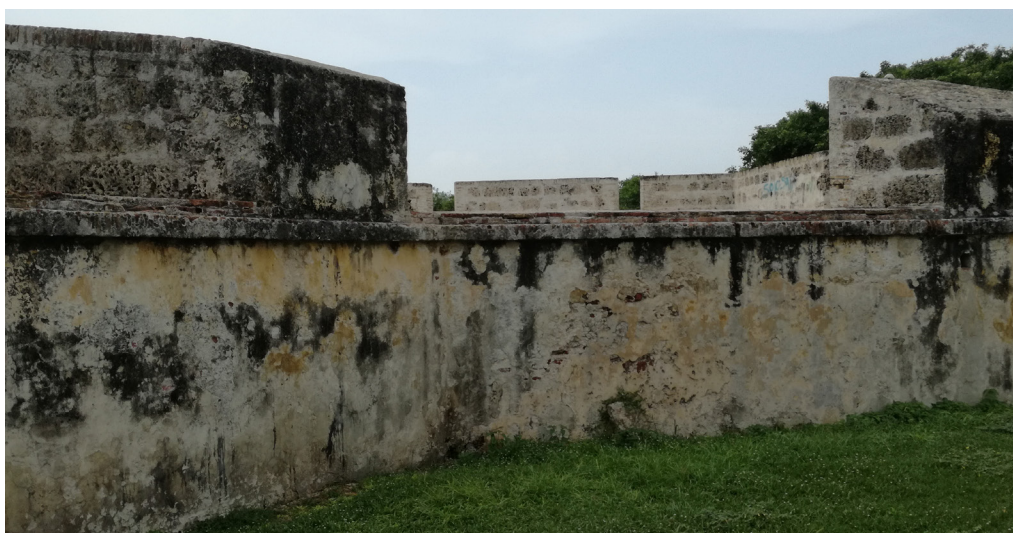
Fig. 102: Colorazione gialla di alcune pareti delle fortificazioni dovute all'applicazione della gutagamba .
