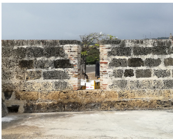
Fig. 90: Presenza di degrado nel materiale nei merloni interni del baluarte, in cui si deve adottare una sostituzione del blocco lapideo di costruzione.
