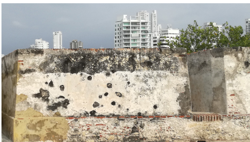
Fig. 96: Presenza di macchie nere sul materiale nella parte esterna del baluarte. Degrado dovuto all'esposizione e all'azione costante dell'acqua.
