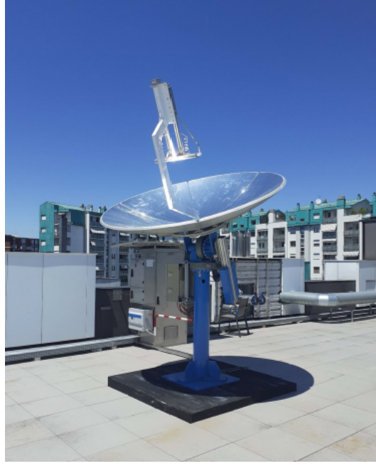
Figura 1.10: Concentratore solare a disco installato sul tetto dell'Energy Center
