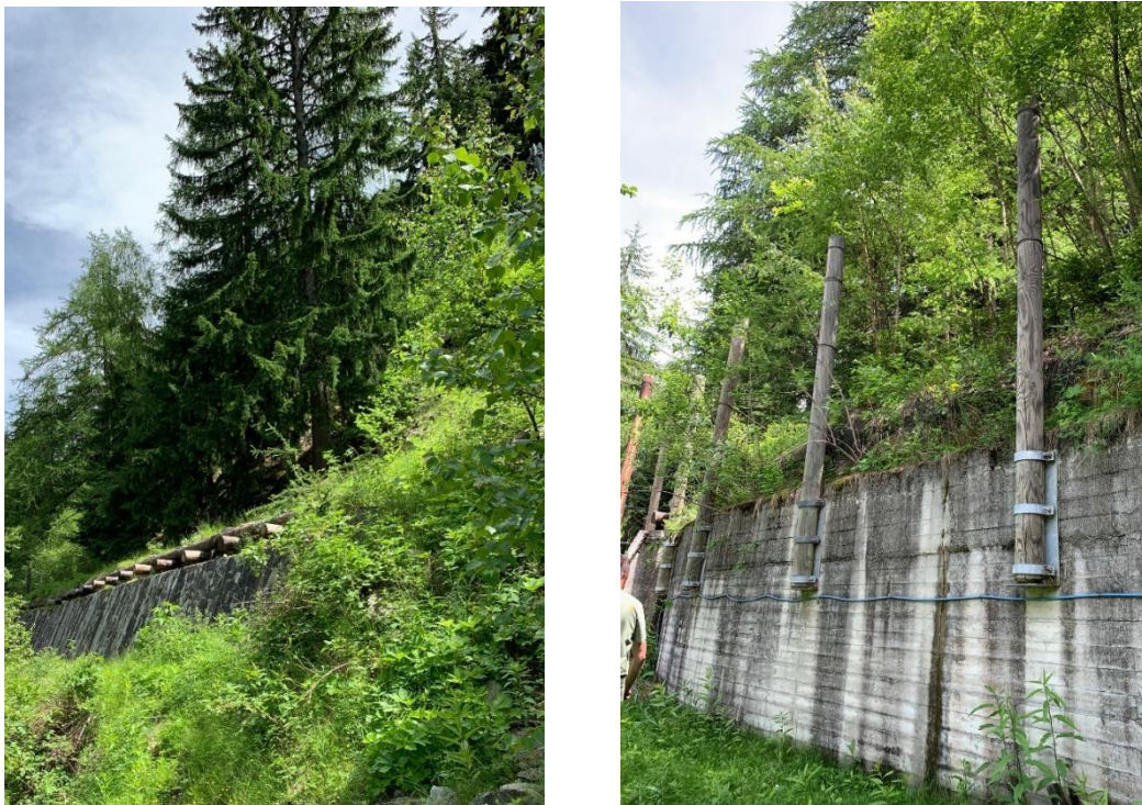
Figura 5.3.3 Ramo La Nuova, installazioni paramassi esistenti.
