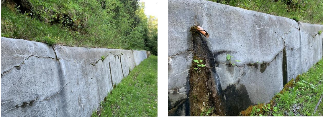
Figura 7.3.1.1 Evidenti fessurazioni esterne lungo il paramento murario del canale.
