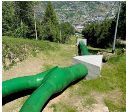
Figura 2.4 Condotte forzate mettono in comunicazione il bacino idroelettrico di monte con le turbine della centrale idroelettrica a valle.
