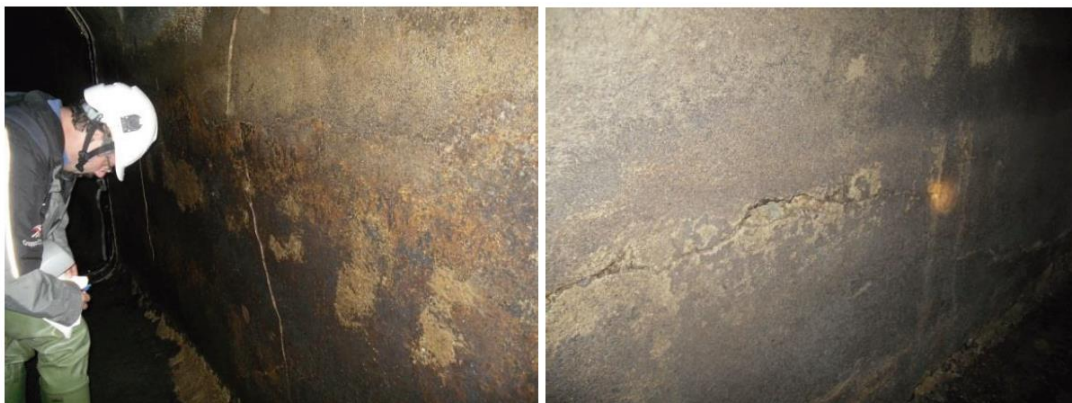
Figura 7.3.1.2 Corrispondenti fessurazioni interne lungo il paramento murario del canale.
