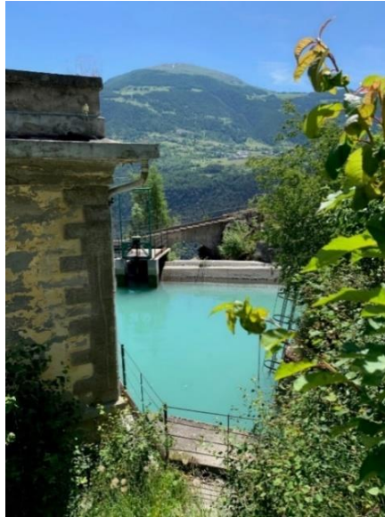
Figura 2.3 Vasca di Poignon, bacino idroelettrico dove si raccoglie l’acqua dei canali derivatori. Attraverso le condotte forzate l’acqua raggiunge le turbine della centrale idroelettrica.
